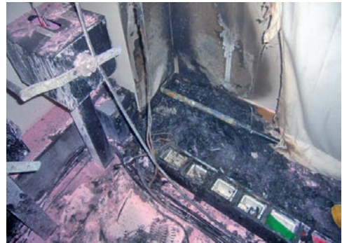
出火箇所の状況
