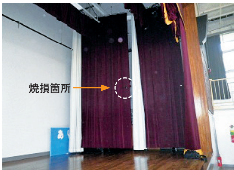
焼損した防災品である袖幕
