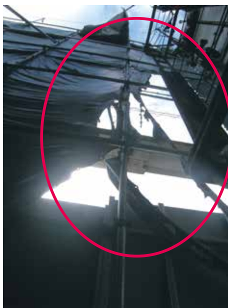
写真5 防災シートの中間から上部に燃えている状況
