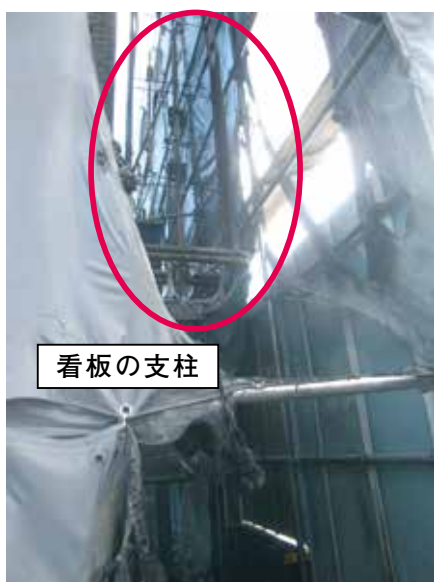
写真3 看板の形状に沿って工事用防災シートが燃焼・溶融した部分
