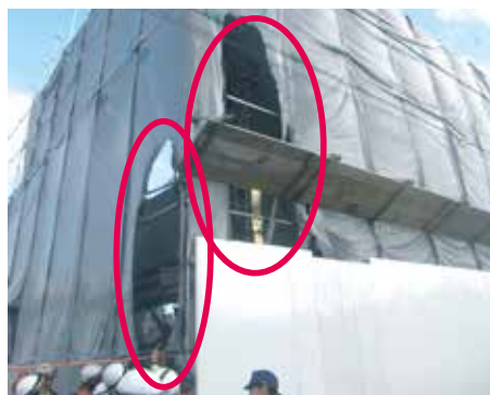
写真1 工事用防災シート2か所が溶融した部分
