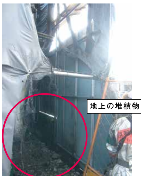
写真4 地上付近の防災シートの焼失状況
