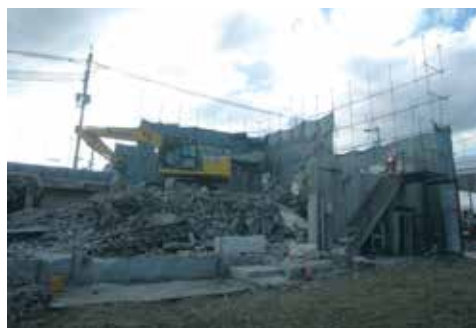
写真2 建物の解体が進んでおり、外壁の解体がほぼ終わっている状態
