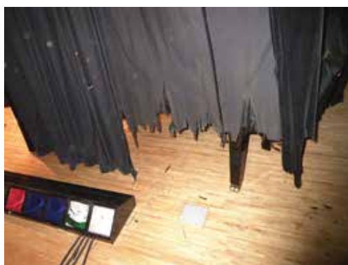
延焼を防いだ袖幕の状況
