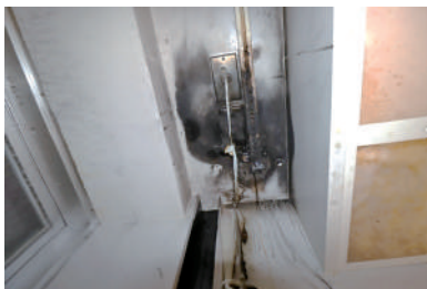
電気コンセント周辺
