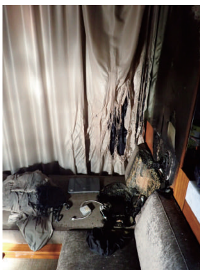
カーテンの焼損状況
